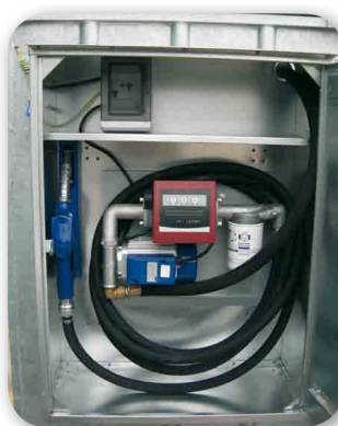
Armoire permettant la mise sous clé du matériel de pompage
