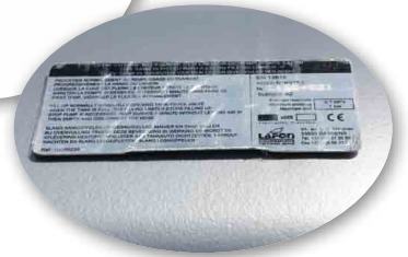
Limiteur de remplissage, sur raccord pompier, avec plaque de conformité prouvant l'installation du limiteur
