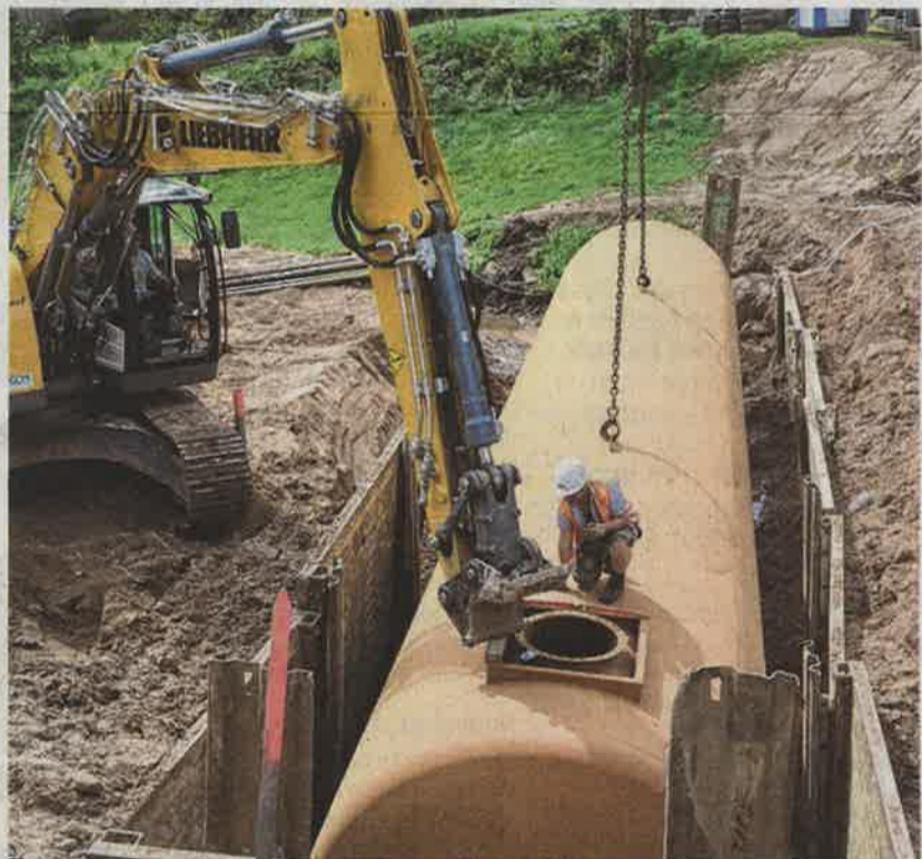
Après la pose, il aura suffi d'une grosse pelleuse, d'un conducteur expérimenté et d'une petite poussée pour mettre la citerne à niveau.
